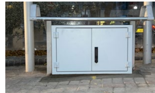
«Bus stop» cabinets
